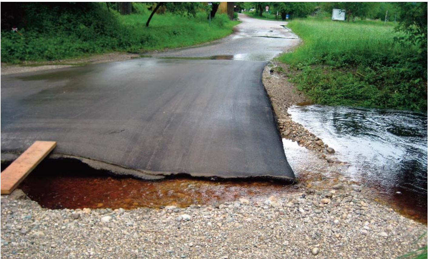
Abb. 5: Unterspülte Straße an der Bahnunterführung, rechts der Zulauf des Moorwassers aus dem Hauptgraben. Das auflaufende Wasser konnte durch den tieferliegenden Kanal (Abb. 2) immer noch nicht vollständig abführt werden (siehe Strudel rechts im Bild). Man stelle sich vor, hier lägen noch etliche Kubikmeter Holzschrott aus den Biberverbauungen.
