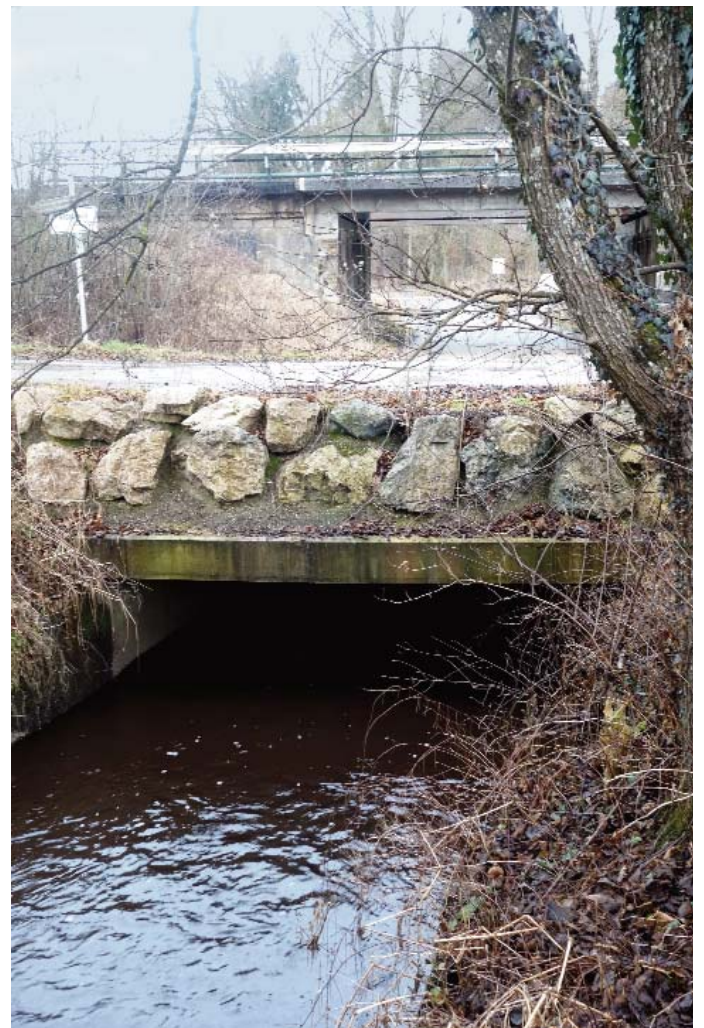
Abb. 2: Gedeckter Kanal für den Moorwasserablauf aus den Filzen durch die Bahnunterführung (Hintergrund) am Torfbahnhof: normaler Zustand.
