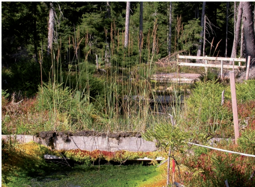
Abb. 12: Eine der am Anfang der Eingriffe errichteten Sperren im Harzmoos, die schon brüchig wird und mit Rohrkolben, Reitgras und Schlagpflanzen bewachsen ist (08.09.2014).
